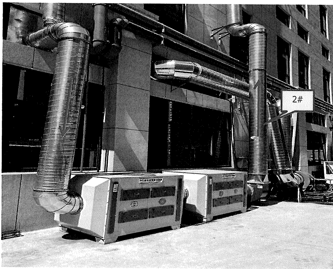
图 3-2 废气处理工艺现场照片
